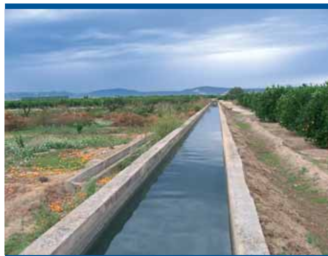
Sèquia de Carcaixent a su llegada al Partidor Nou (Carcaixent)
